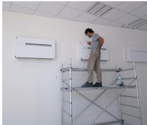
Climatisation de la salle du troisième âge
